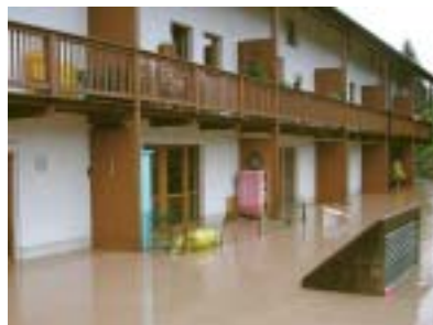
Schwachstelle Lüftungsschacht. Über den nicht gesicherten Lüftungsschacht (re.) strömt das Wasser in die darunterliegende Tiefgarage.
