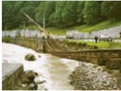
Restrisiko. Hundertprozentige Sicherheit vor Hochwasserschäden gibt es nicht. Selbst massive Ufermauern können nachgeben.
